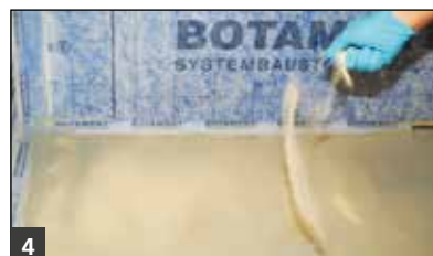
4 Abstreuen der zweiten Abdichtungslage mit Quarzsand (Körnung 0,5- 1,2 mm) für die anschließende Fliesenverlegung
