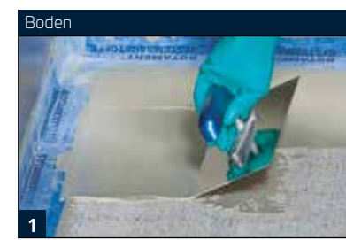
1 Auftragen der ersten Lage RA 170 Reaktionsharzabdichtung auf dem mit E 120 grundierten Boden und einbetten von SB 78 Systemdichtband + Innenecke
