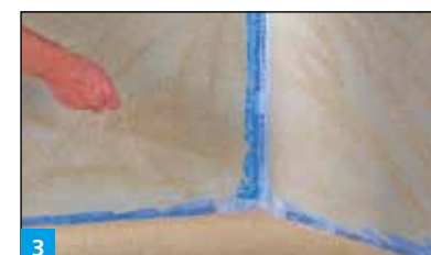
3 Abstreuen der zweiten, frischen Lage RA 170 mit getrocknetem Quarzsand für die nachfolgende Fliesenverlegung
