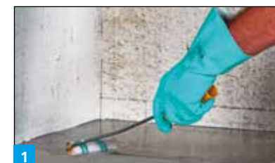
1 Grundierung der Wand- und Bodenflächen mit E 120. Bei grobporigen Untergründen ist eine Kratz- und Lunkerspachtelung aus E 120 (gemischt mit getrocknetem Quarzsand) vorzunehmen.
